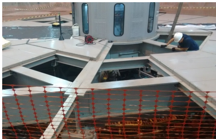
Manutenção das unidades geradoras é fundamental para o bom desempenho da Usina Hidrelétrica Campos Novos
